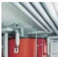
Gedämmte Leitungen halten die wertvolle Wärme im Rohr.
